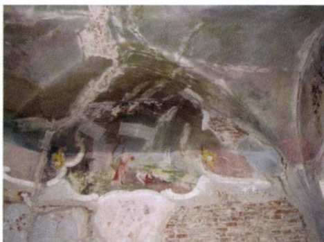
23. kép. 110. szoba, Thisbe. A megroppant fal-szerkezet darabjai leomlással fenyegettek. Fig. 23. Room 110, Thisbe. The cracked pieces of wall were close to falling off.
