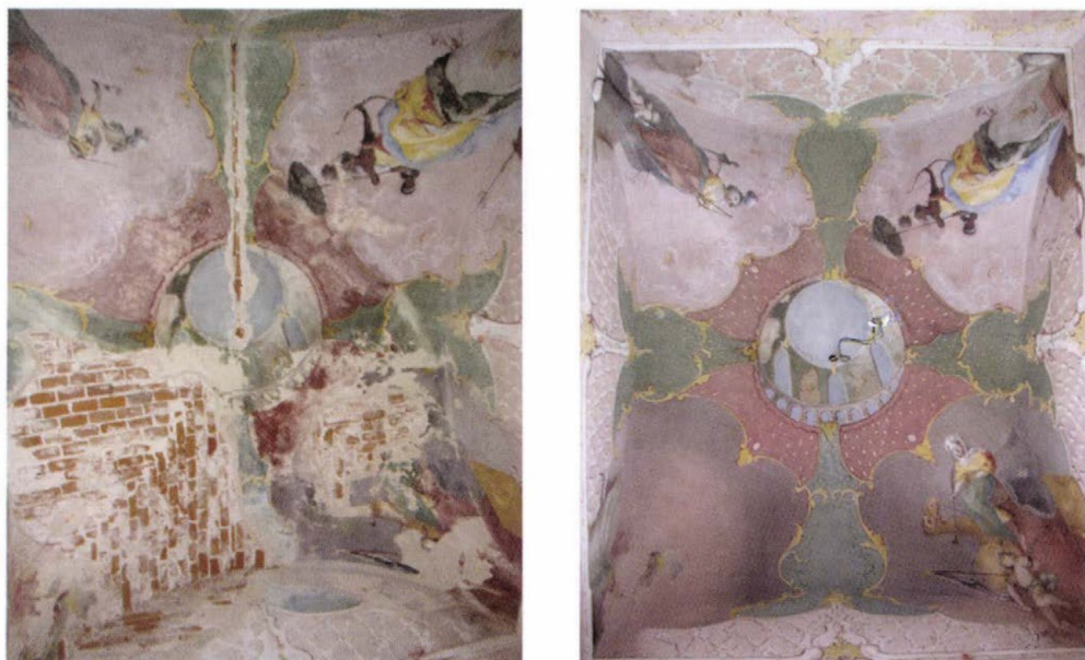
30. kép. 112 szoba. a) A mennyezet beázás miatt roncsolódott felülete restaurálás előtt, b) a restaurált mennyezet a kiegészítésekkel.
