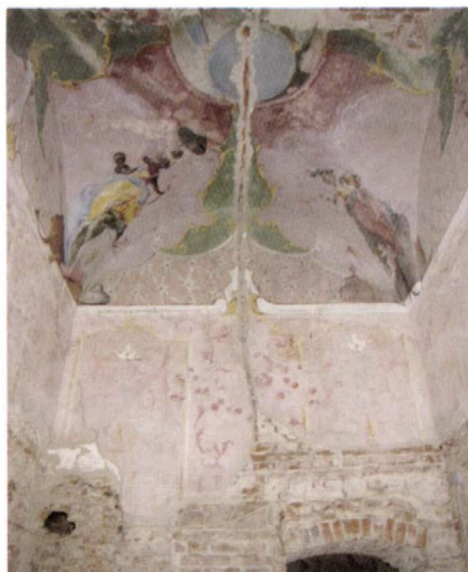
29. kép. 112 szoba. Leromlott állapot restaurálás előtt.
